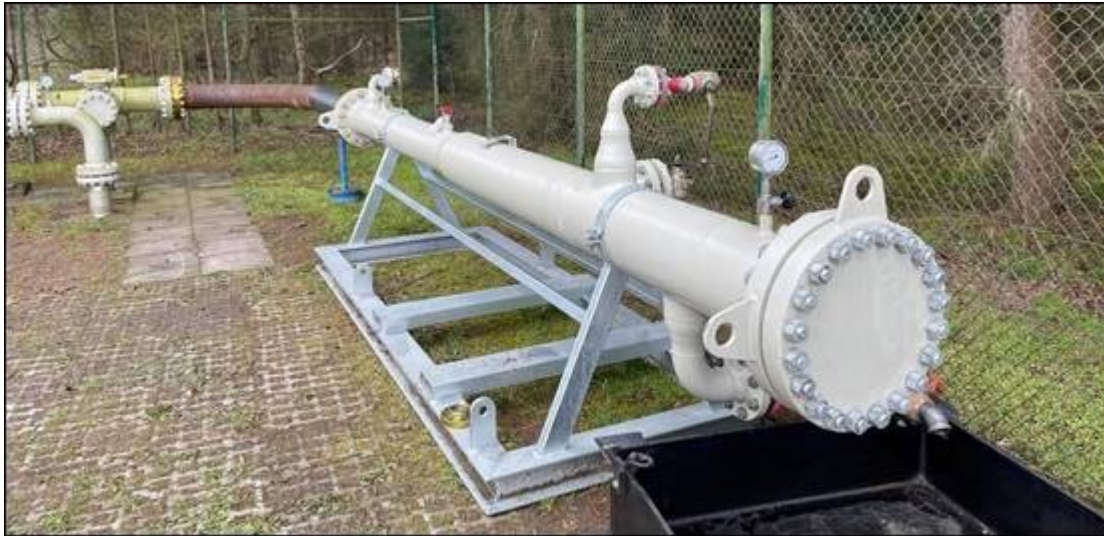
Abbildung III.6.5: Empfangsschleuse Station Schepsdorf
