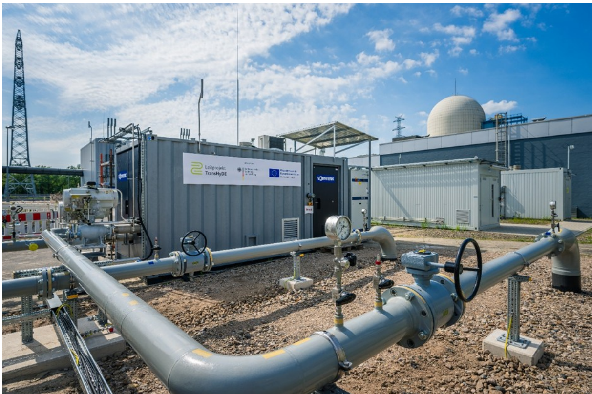
Abbildung III.2.5: Ansicht des Testloops am Kraftwerkstandort Lingen Außenbereich
