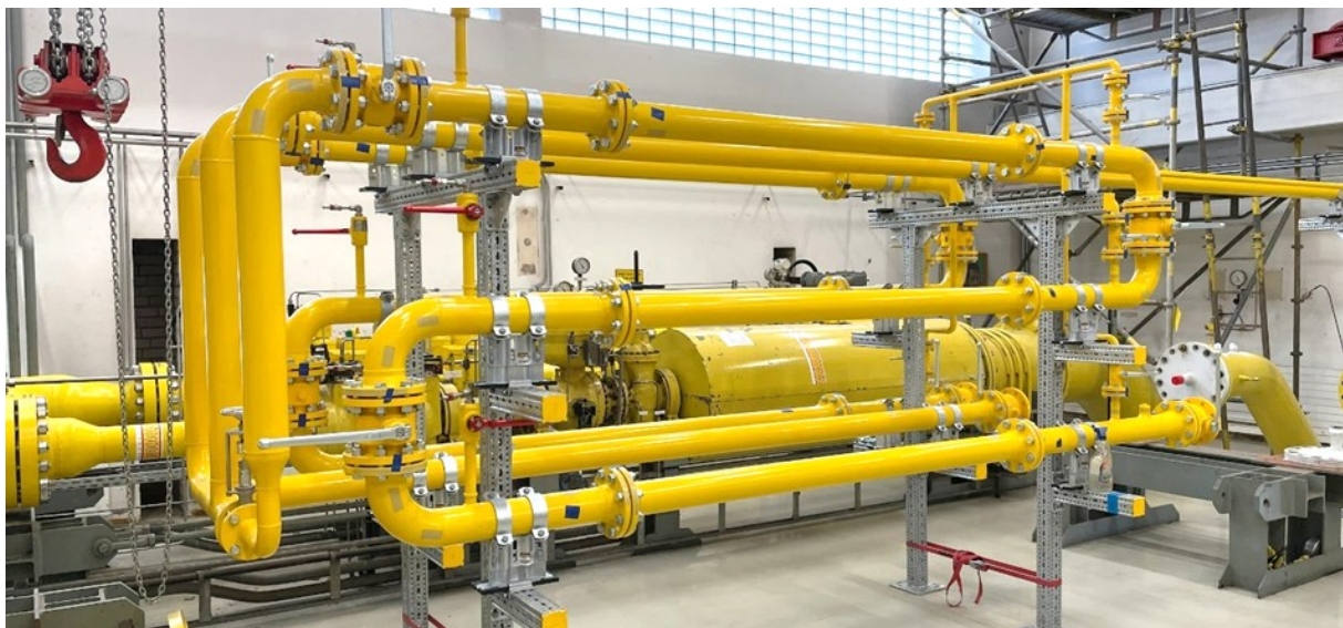
Abbildung III.4.2: GETH2 TransHyDE -Loop Materialprüfstand mit sechs Passtücken im Betrieb vor Einbau der Teststrecken aus betriebsbeanspruchten Rohrsegmenten
