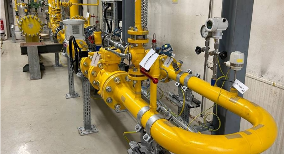
Abbildung III.3.13: Zählermessstrecke am H 2 -Loop in Lingen
