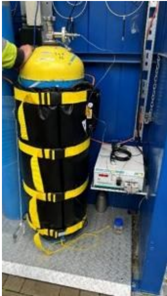
Abbildung III.3.9 a: beheizter Ammoniakzylinder mit Dosierpumpe.
