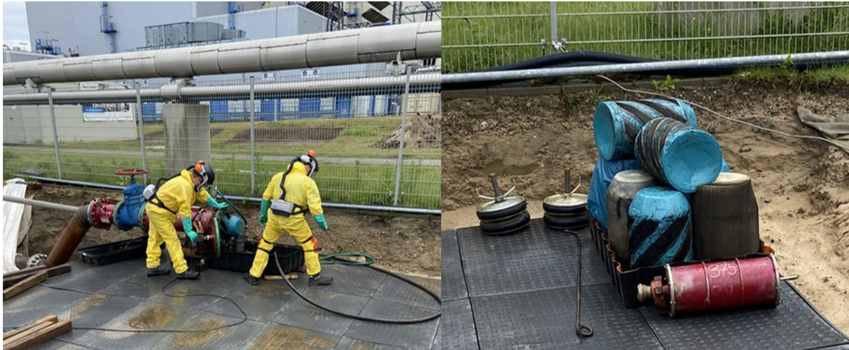
Abbildung III.2.4: Durchführung der Molchung der Bestandsleitung (links), Molche (rechts)
