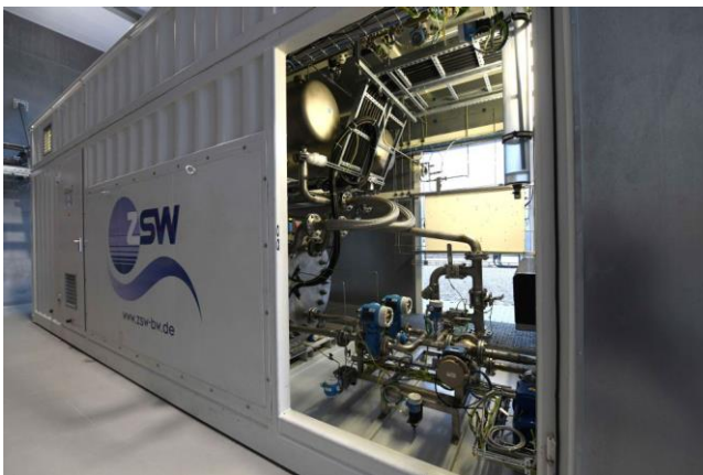
Blick in das Innere der Anlage.
